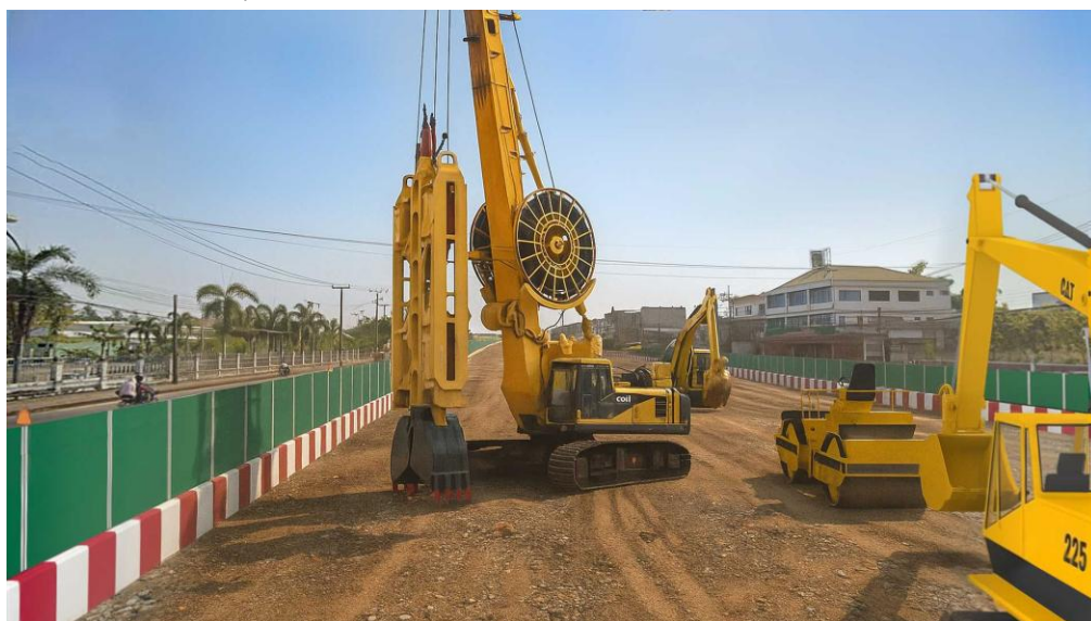
ภาพเสมือนจริงแสดงพื้นที่ก่อสร้าง ในระหว่างการก่อสร้างระยะที่ 2
